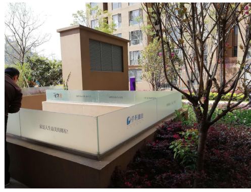
地下车库排气口
