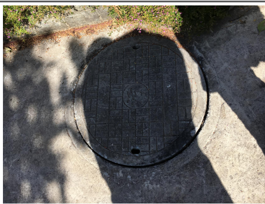
项目区化粪池
