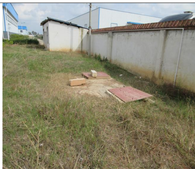
污水处理站的污水收集池
