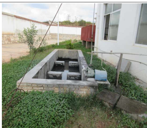
锅炉脱硫塔碱液循环池
