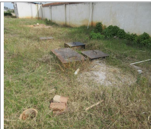
项目污水处理站
