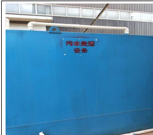
一体化污水处理设施
